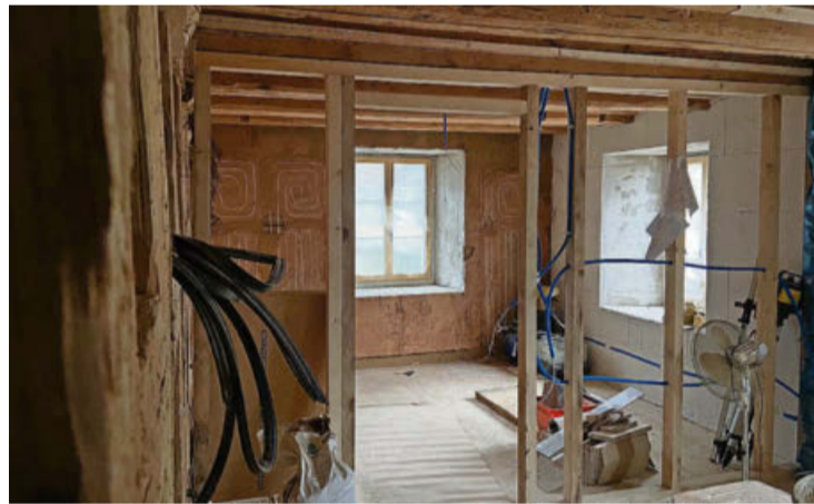
Wie im hinteren Bereich dieses Raums erkennbar ist, wird Lehm als Verputz verwendet. Dies gilt für den gesamten Innenbereich.
